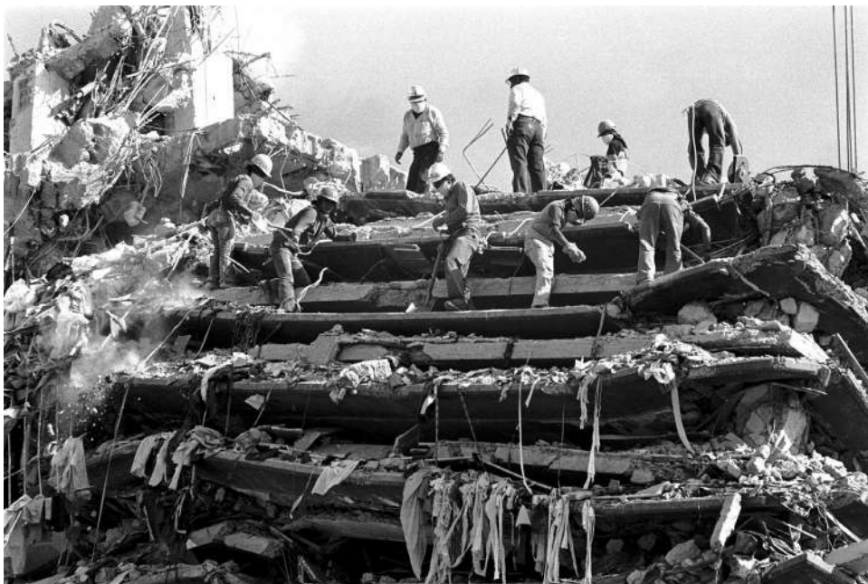
Edificio en la ciudad de México derruido por el terremoto de 1985.
